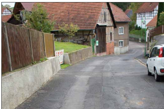
Abb.59.: Straßenzustand Kentelsgasse Görlingen, Quelle: Eigene Aufnahme
