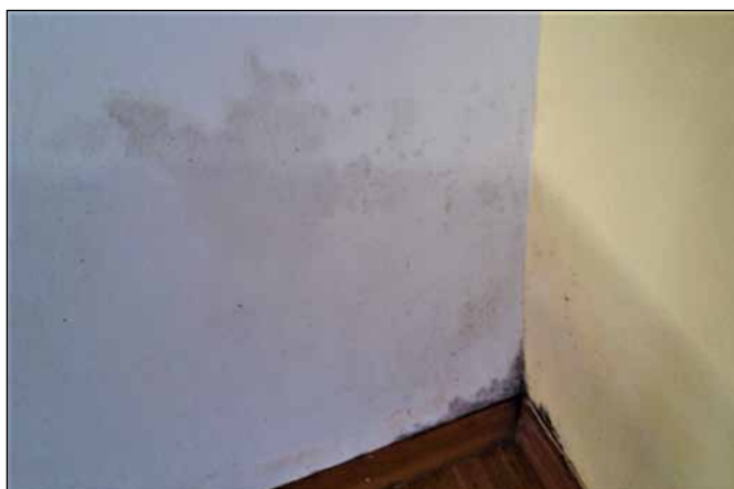
Abb.91.: Schimmelflecken im DGH Neuenhof, Quelle: Büchner, Gisela
