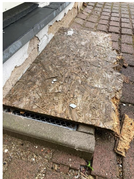
Abbildung 18: Links: Innenhofbereich des Ernst-Abbe-Gymnasiums, Rechts: Provisorische Sicherung eines Lichtschachts und Vernässungsschäden an Bausubstanz im Innenhofbereich zwischen der Wartburgalle und Kleine Löbergasse
